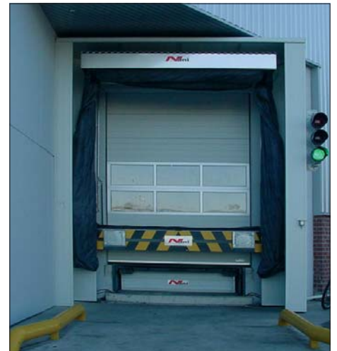
Isolierte Verladestelle mit einer Ampelanlage.
