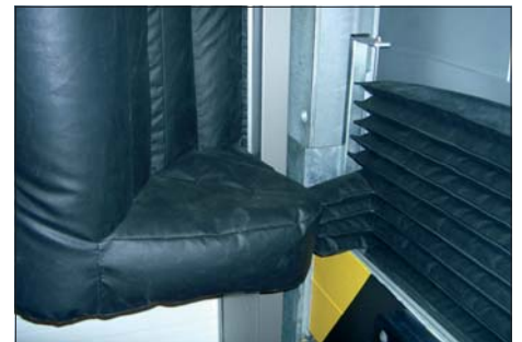
Die vierseitige Torabdichtung dichtet die Verladestelle nahezu hermetisch ab.
